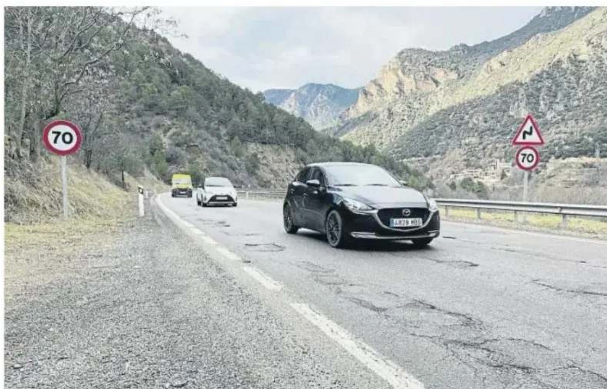
Coches circulando, ayer, por la N-260, carretera que presenta un asfaltado ciertamente mejorable
